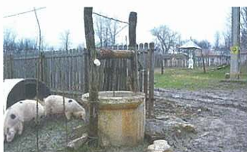
AȘA NU Fântână degradată și greșit poziționată, prea aproape de animale.
